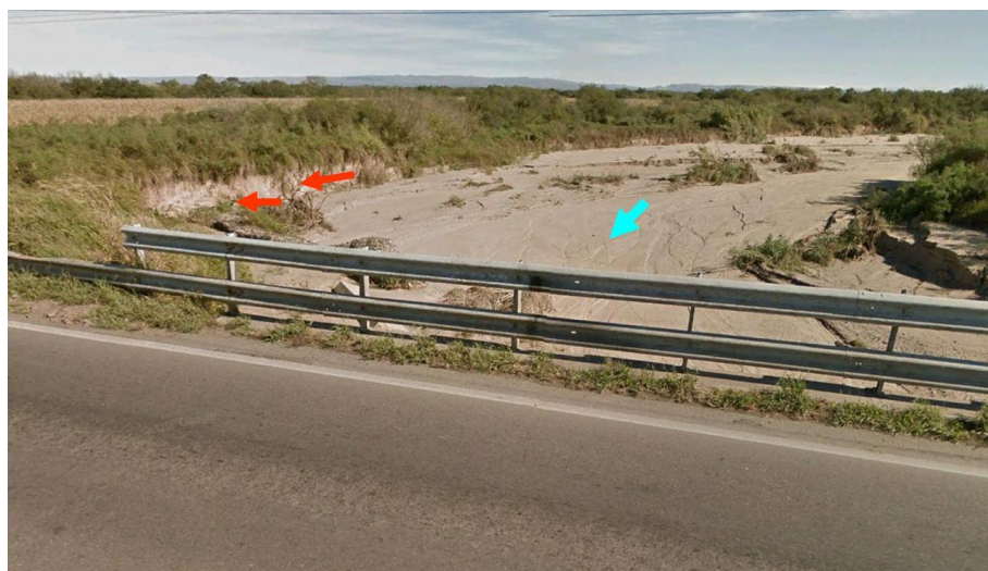
Figura 42. Puente ruta N9 bajo riesgo potencial significativo por erosión de márgenes (margen derecha) por migración de curva meándrica.
